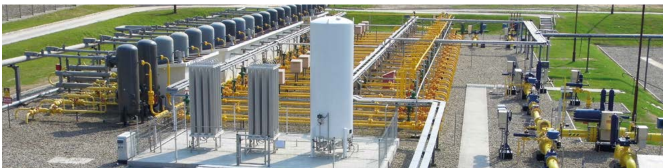
Rozbudowa PMG Husów (Polskie Górnictwo Naftowe i Gazownictwo SA), wartość projektu – 76,7 mln zł, dofinansowanie z UE – 35,2 mln zł (POIiŚ 2007-2013).
